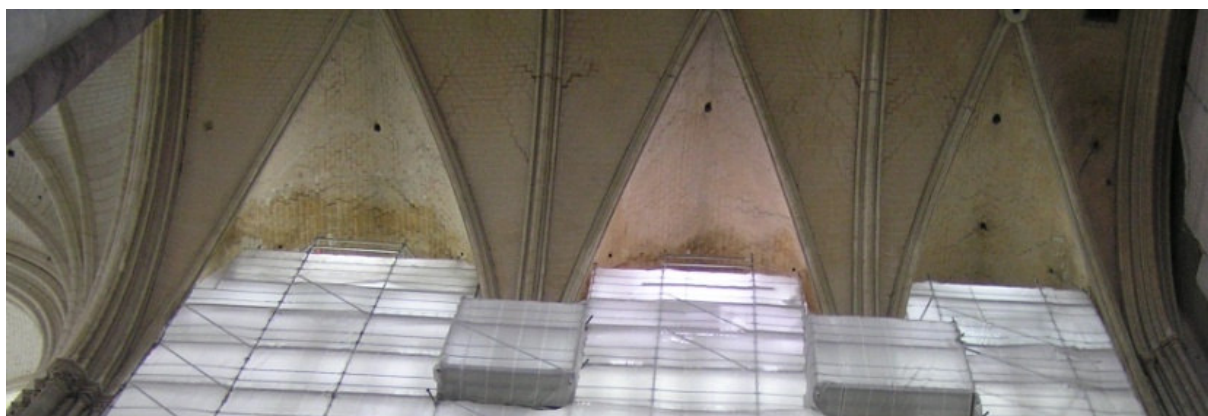
Obr. 6.20 – Amiens, katedrála Notre-Dame, trhliny v klenbě jižního transeptu
