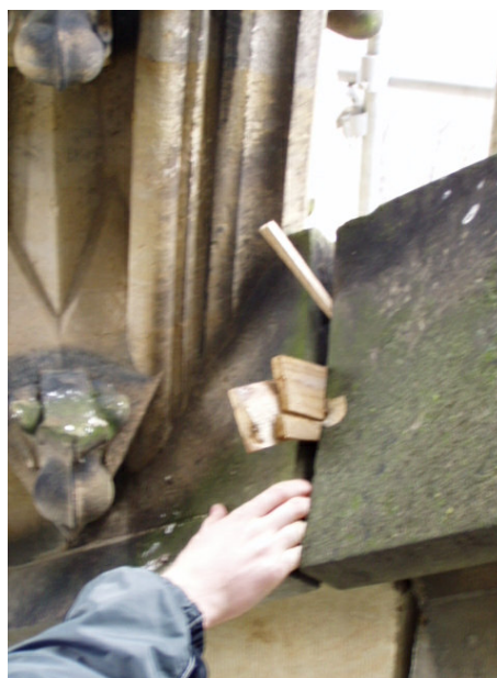
Obr. 6.26 – Kutná Hora, chrám sv. Barbory, opěrný systém OsLJ7, otevřená spára mezi stříškou dolního oblouku a pilířem
