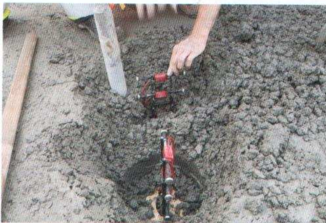
Obr. 5 Poloha čidel před betonáží spodní vrstvy CBK s příměsí strusky (nahore), vstavení čidel a jejich poloha před pokládkou horní vrstvy CBK (dole)
